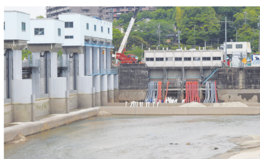
漏水による水位低下で取水ができず、ポンプで水をくみ上げている明治用水頭首工＝20日、豊田市 (村瀬和弘撮影)
